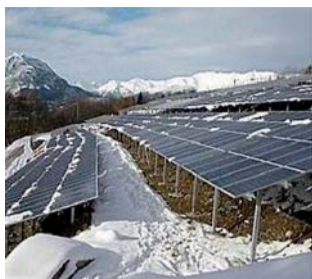
Cevo: Il parco fotovoltaico
