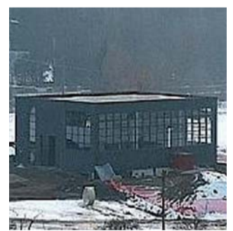
Temù: L'edificio della "megacentralina"
