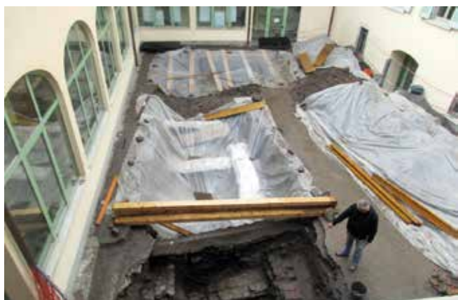
Cividate Camuno: Gli scavi nell'atrio dell'edificio che sarà la nuova sede del Museo Archeologico Nazionale.
