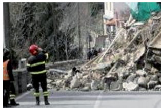
Losine: Il muro crollato
