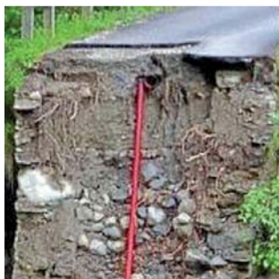
Ceto: Il punto del distacco del ponte
