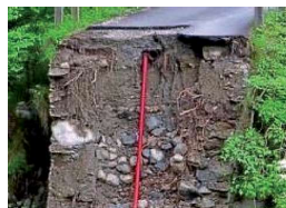
Ceto: I resti del vecchio ponte dopo il cedimento
