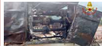
La centralina del gas della Riva Acciai colpita da un fulmine causa dell'incendio.
