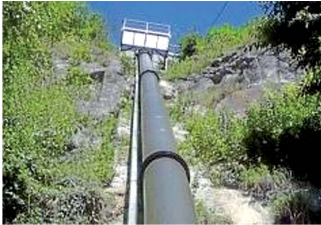
Malegno: La condotta della centrale Idroelettrica.
