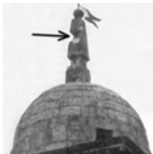
Evidente il danno provocato dal fulmine alla torretta che sostiene la croce in cima al campanile.
