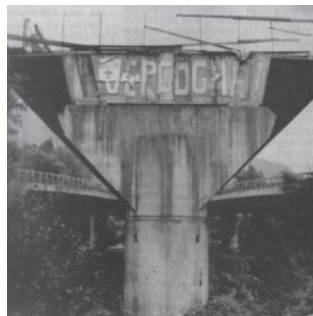
Il pilastro della vergogna rimasto abbandonato per oltre 10 anni.
