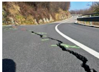
I segni della frana.
