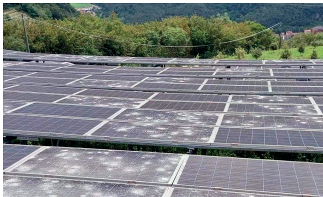
Pannelli fotovoltaici bucherellati dalla grandine.
